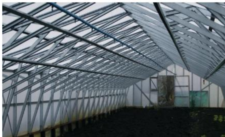
Fig. 2.5. Interior de un invernadero de estructura metálica a dos aguas.
