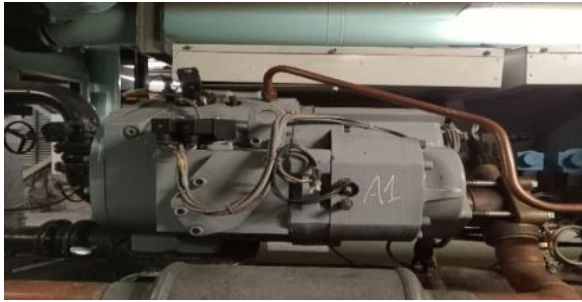
Imagen N° 3-1 Compresor tornillo Fuente: Clínica Indisa
