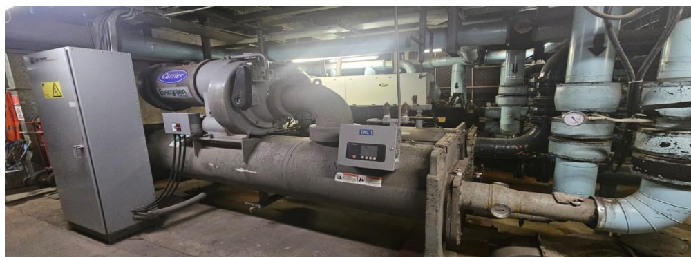
Imagen 1-2: Chiller Centrífugo marca Carrier (Fuente: Clínica Indisa)
