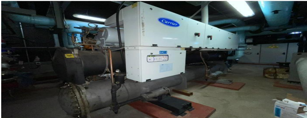
Imagen1-1: Chiller Tornillo marca Carrier (Fuente: Clínica Indisa)
