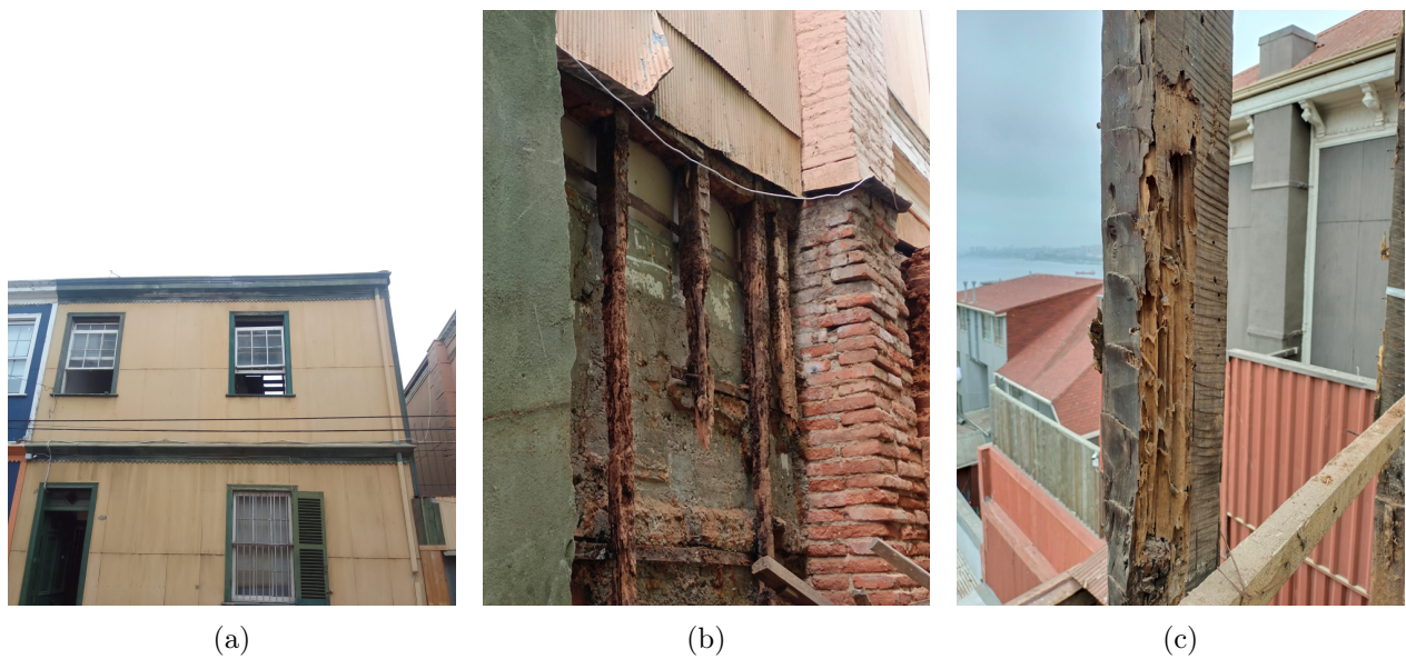
Figura 2: Fotografías tomadas en Pasaje Higuera, Cerro Alegre, Valparaíso (10-03-2023): (a) Fachada de la Vivienda, (b) Pies derechos destruidos y (c) Pie derecho con daño avanzado por termitas.
