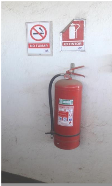
Fuente: Imagen de elaboración propia AGRÍCOLA LOMAS DE POCOCHAY S.A Figura 4-4. Señalética y sistema de extinción de incendios al interior bodega de pesticidas Empresa AGRÍCOLA LOMAS DE POCOCHAY S.A
