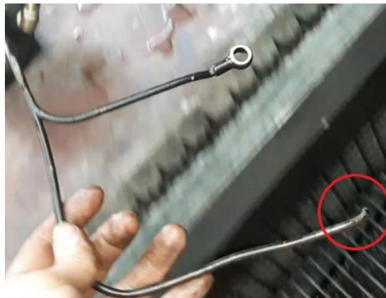
Figura 27. Cañería de retorno desgarrada en una de sus vías.
