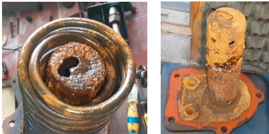
Figura 13. Intercambiador de calor de la parte superior del sifón dañado por corrosión.
