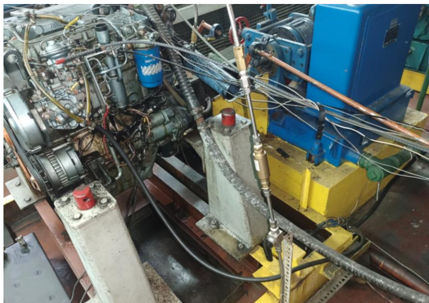
Anexo 7. Línea de suministro de combustible del motor marino Perkins.
