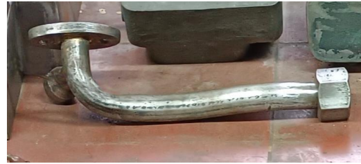
(b) Cañería de entrada al bloque
