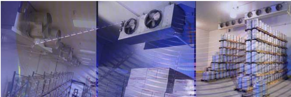
Figura 23: Ejemplo Cámaras con Evaporadores (Fuente: Krack, 2021).
