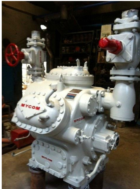
Figura 25: Compresor de Amoníaco tipo Pistón (Fuente: Elaboración Propia, 2021).
