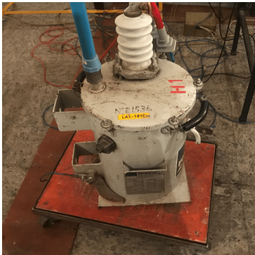
(a) Detalle del transformador RHONA
