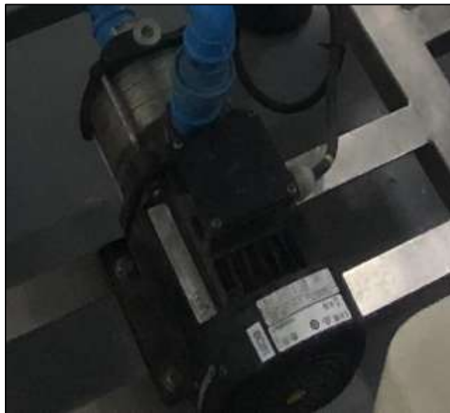
Figura 8: Bomba Centrífuga pretratamiento.
