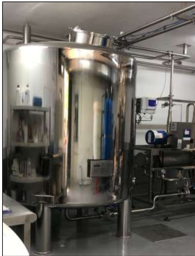
Figura 14: Tanque de almacenamiento.
