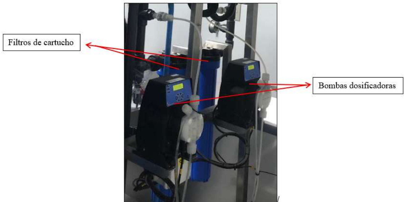
Figura 10: Bombas dosificadoras y filtro de cartucho.
