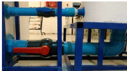
Figura 5.18. Conexión entre el estanque volumétrico y el estanque de almacenamiento.
