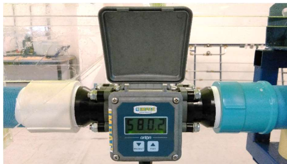
Figura 6.1. Caudalímetro instalado y funcionando, medición del caudal en [L/min].
