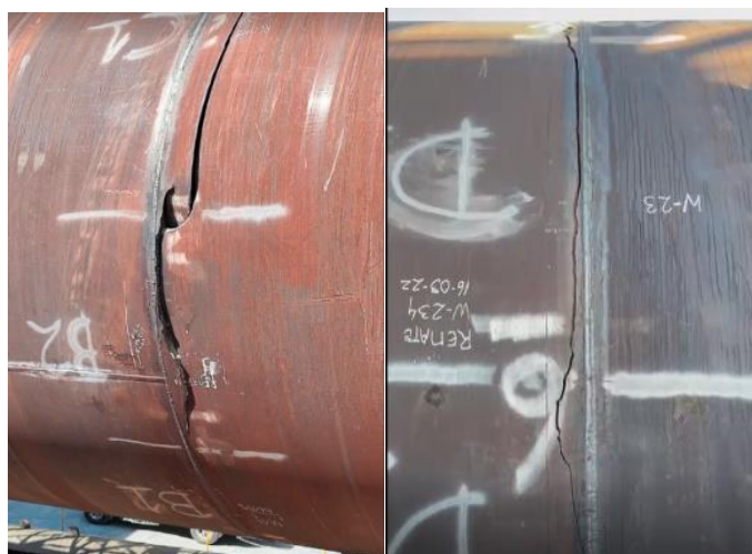
Figura 24 fisura horno N°9
