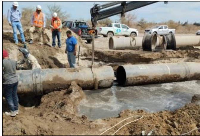
Figura 3-9: Rotura tubería de impulsión Canchones-Diana. Fuente: SISS 2023.
