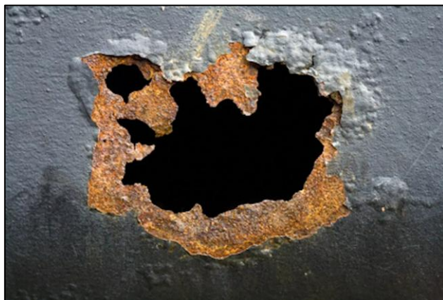
Figura 5-2: Falla por corrosión en elementos de un sistema de agua. Fuente: Merus. s.f.
