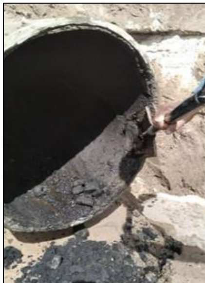
Figura 3-10: Precipitación de Mn al interior de la tubería de impulsión Canchones-Diana.
