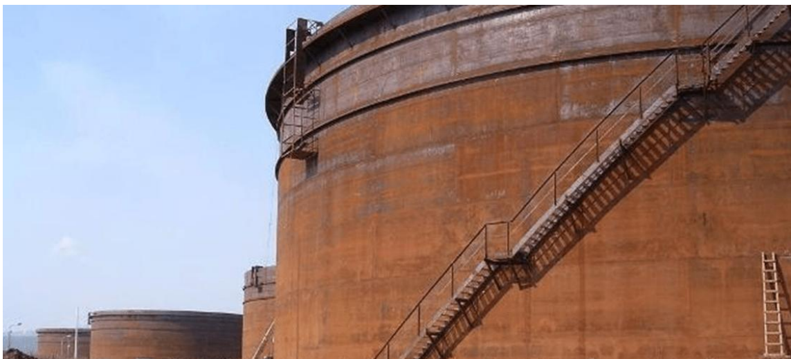
Figura 2: Corrosión en Estanques de Almacenamiento tipo Atmosférico.
