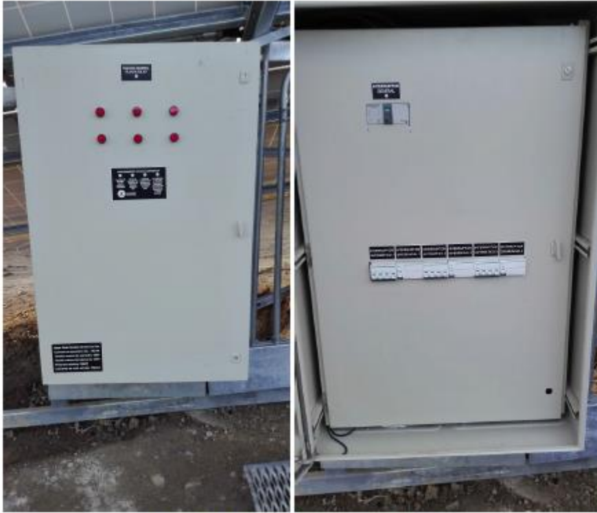
Imagen 4. Tablero General Planta Solar
