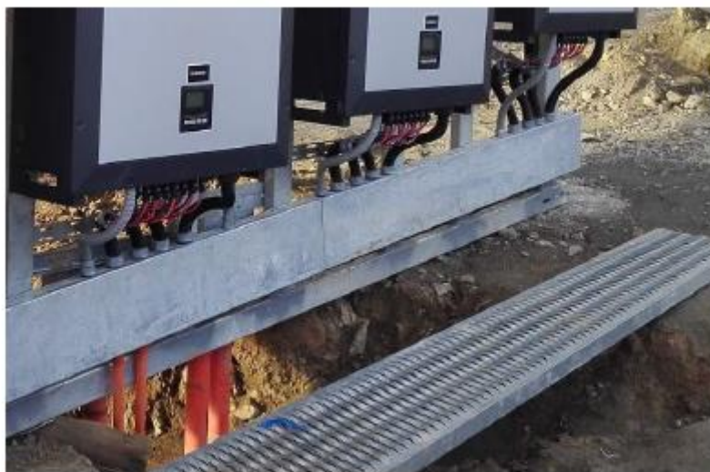
Imagen 10. Llegada canalización DC al inversor y salida AC..
