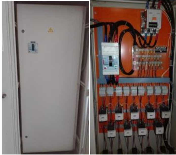
Imagen 16. Tablero de Condensadores Cliente.
