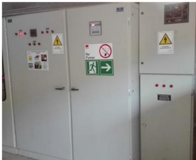
Imagen 18. Tablero General Cliente, Tablero Condensadores y Tableros Auxiliares.
