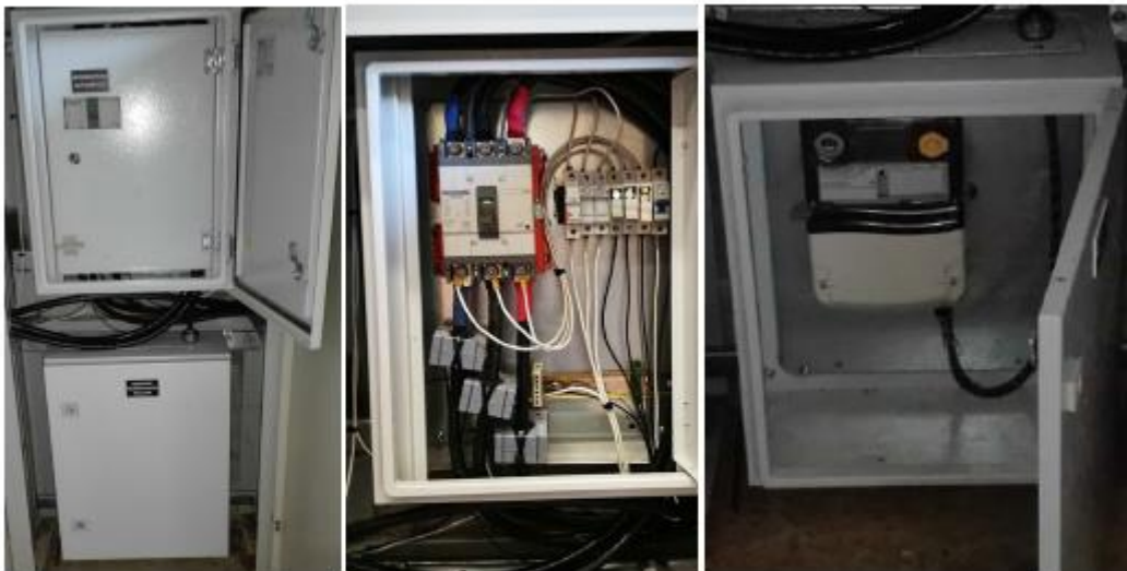
Imagen 5. Tableros Auxiliares Planta Solar.
