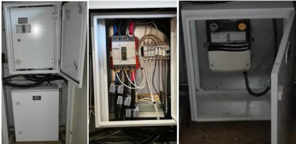
Imagen 15. Tableros Auxiliares Planta Solar.
