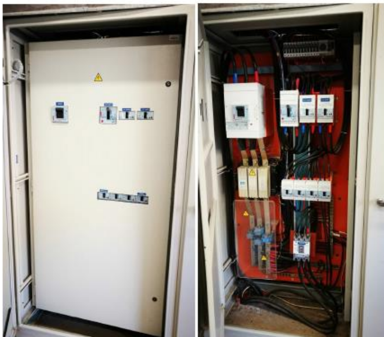
Imagen 15. Tablero General Cliente.
