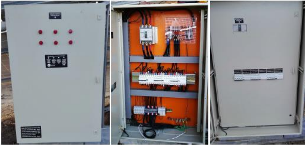
Imagen 14. Tablero General Planta Solar.
