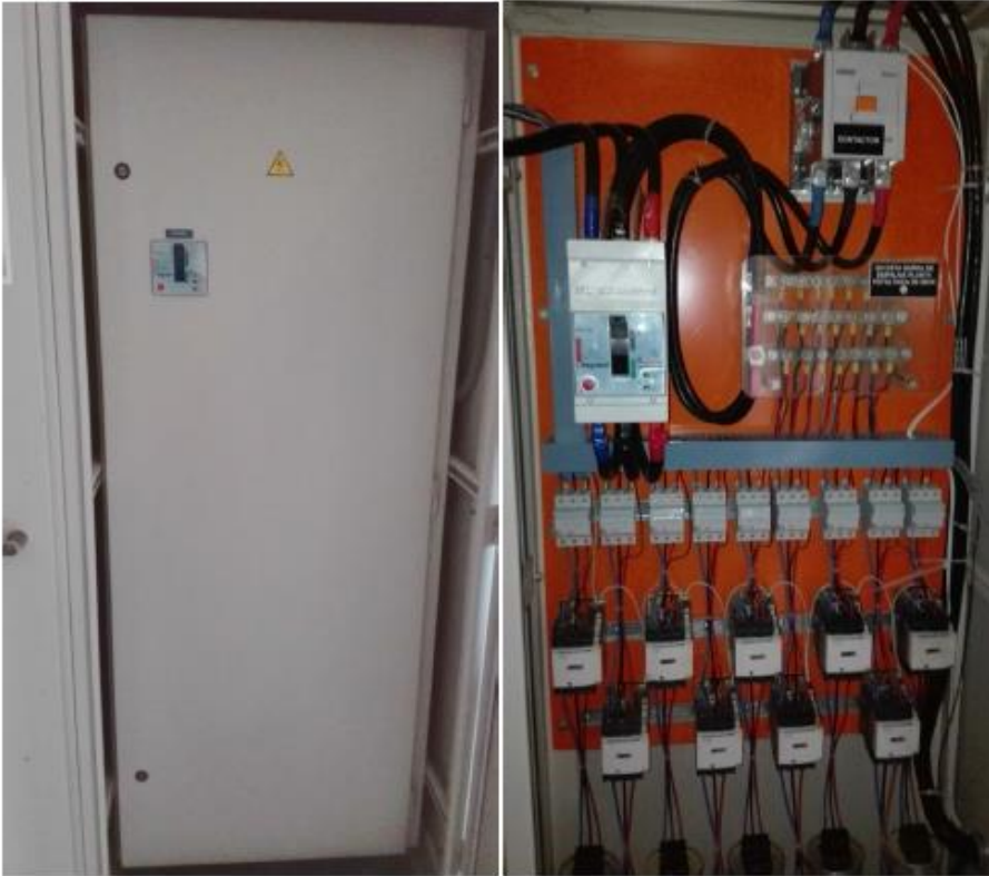
Imagen 15. Tablero de Condensadores Cliente.
