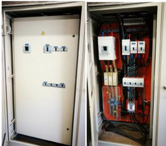
Imagen 17. Tablero General Cliente.
