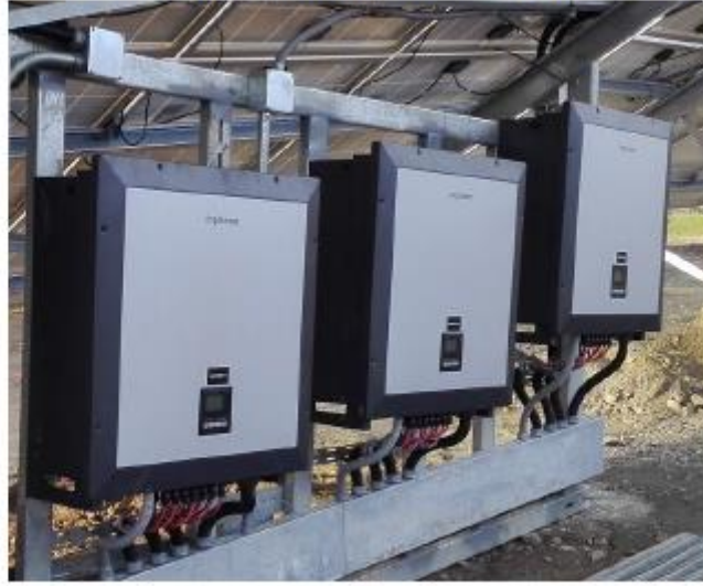
Imagen 11. Inversores Ingeteam Ingecon SUN 33TL.
