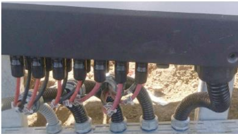
Imagen 9. Llegada canalización DC al inversor y salida AC.
