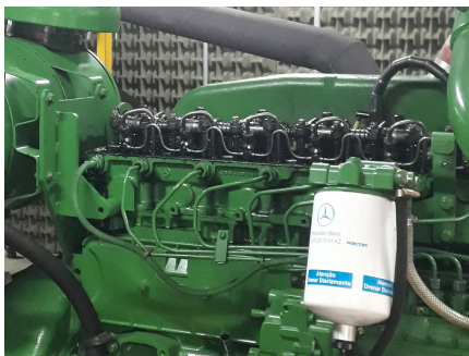
(a) Motor OM366 LA, sin tapa de válvulas
