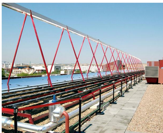
Figura 3-8. Instalación industrial de LFR, España [8].
