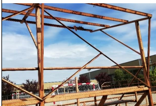
Imagen 3 "Estructura mal estado,2018"
