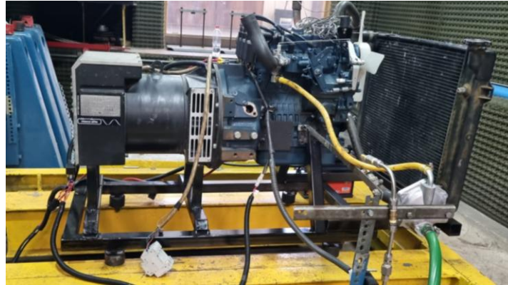
Figura 12: montaje del conjunto motor–generador en el banco de pruebas
