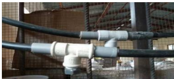
24 Figura 3-15 Ejemplo de Tees a implementar en nuestras cañerías de gas Fuente: biodigestores.es
