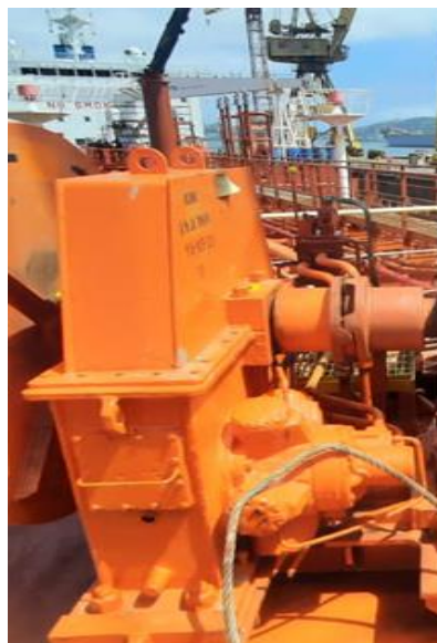
Ilustración 2-4.- Caja Reductora por Fuera
