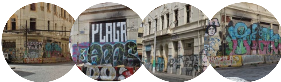
Fig.: Tipos de patologías en los elementos constructivos y sus referencias visuales.
