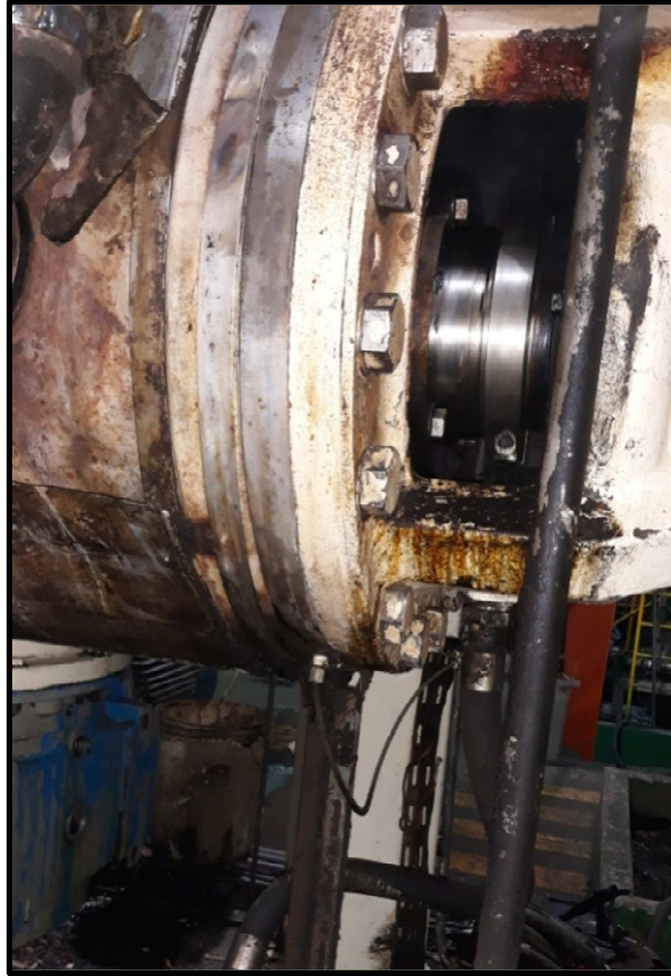
Figura 2-44.: Fotografía punto de lubricación Tornillo descarga Digestor.
