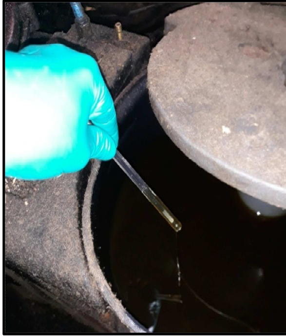
Figura 2-69.: Fotografía donde se aprecia que el Filtro se encuentra saturado de aceite.
