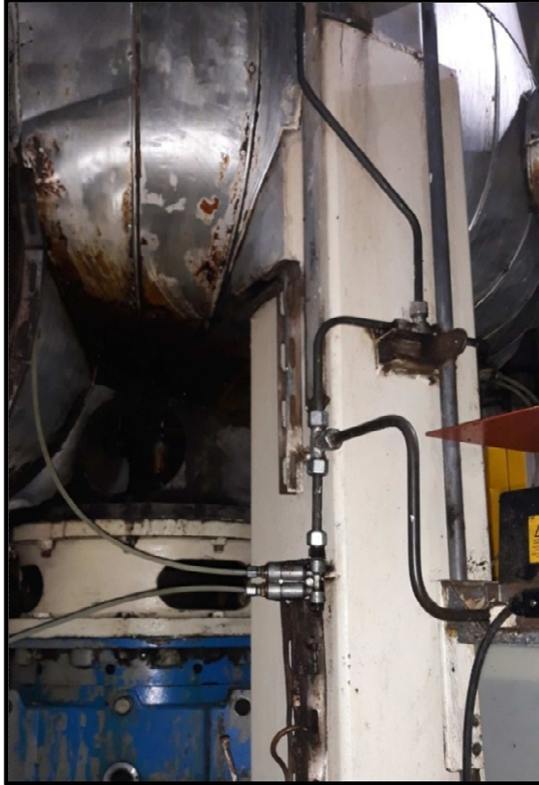
Figura 2-40.: Fotografía líneas de distribución de aceite de lubricación.
