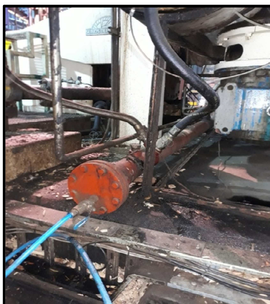
Figura 2-46.: Fotografía receptor del residuo de la lubricación Sellos Mecánicos.
