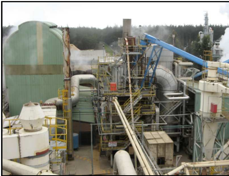
Figura 2-16.: Fotografía Planta Térmica.
