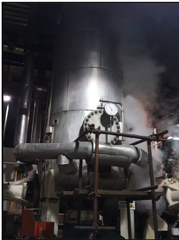
Figura 2-6.: Fotografía Digestor de Chips.
