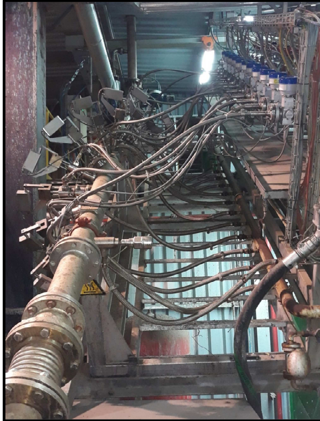
Figura 2-8.: Fotografía Toberas de inyección de Adhesivo.
