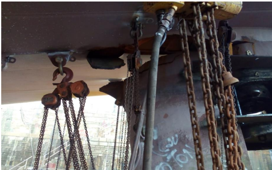
Figura 4-3. Zona de fatiga del Rudder horn. Fuente: Fotografía adquirida en práctica profesional, 2019.
