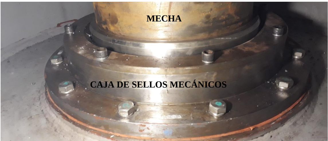
Figura 4-19. Fotografía de la caja de sellos mecánicos de la bocina superior de la Mecha. Fuente: Tomada en práctica profesional, 2019.
