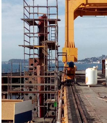
Figura 4-24. Timón instalado verticalmente asegurado lateralmente con cubos de acero.
