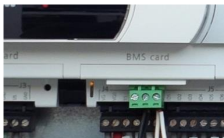
Figura 2-2 “PLC PCO5+ de CHILLER con tarjeta BMS para centralización de datos”
