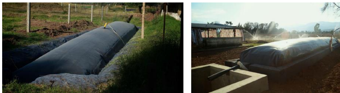
Figura 6.223: Instalación biodigestores. Fuente: Sistema biobolsa
