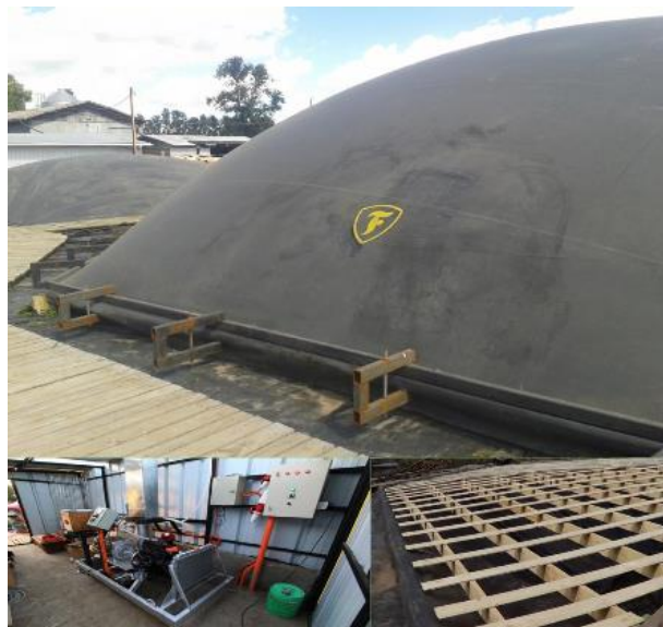
Figura 4.620: Planta biogás Fundo El Cohihue, Purrenque. Fuente: Biotecsur
