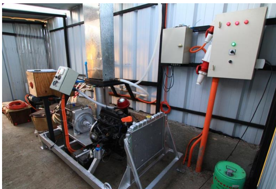
Figura 6.1536: Equipos eléctricos planta 27 kVa Fundo El Coigue. Osorno (250-300 vacas). Fuente: Biotecsur
