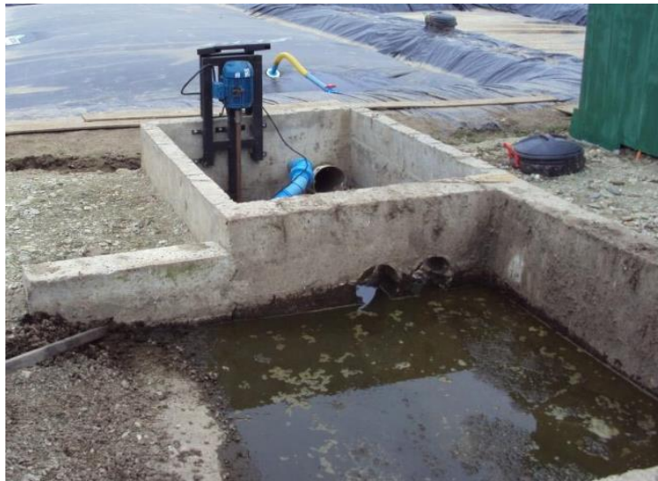
Figura 6.1132: Pozo captación estiércol. Fuente: Biotecsur
