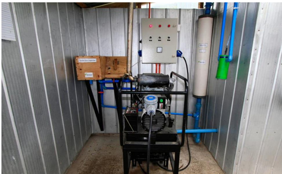
Figura 6.1435: Equipos eléctricos planta 12 kVa El Coigue. Osorno (50 vacas). Fuente: Biotecsur
