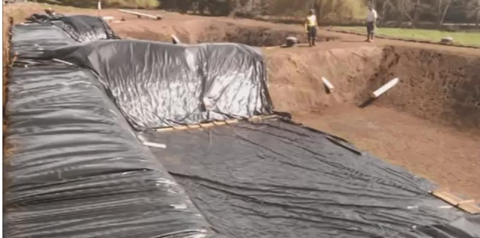
Figura 6.425: Planta biogás Fundo El Cohihue, Purrenque. Fuente: Biotecsur
