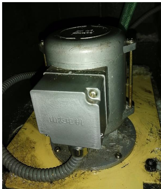
Figura 1-7 Bomba sistema refrigeración
