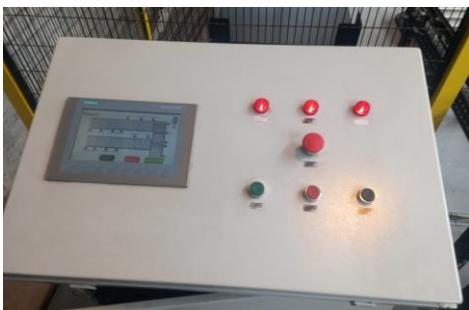
Figura 3 - 7 Tablero eléctrico principal
