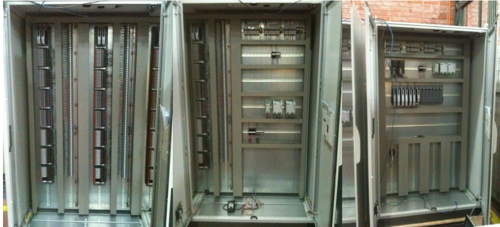
Figura 3.4: Gabinetes de Controladores DeltaV
