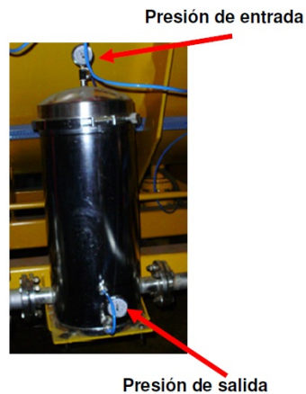
Figura 1.16: Filtro de agua de retrolavado
