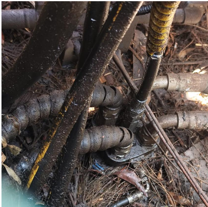
Figura 1 42: Fuga de aceite hidráulico.
