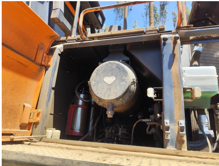
Figura 1 27: Habitación filtro de aire primario y secundario.
