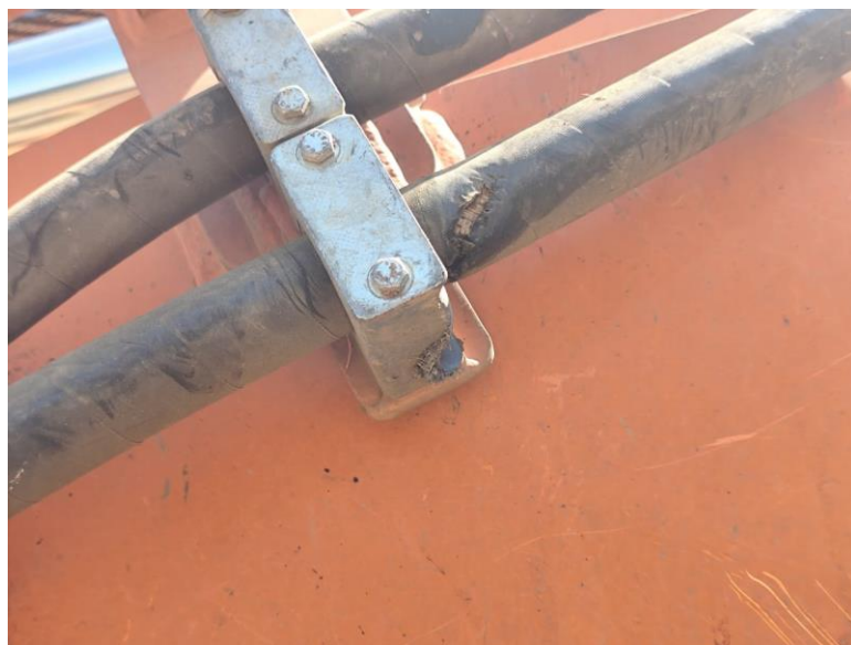
Figura 1 44: Manguera hidráulica con falta de recubrimiento exterior.
