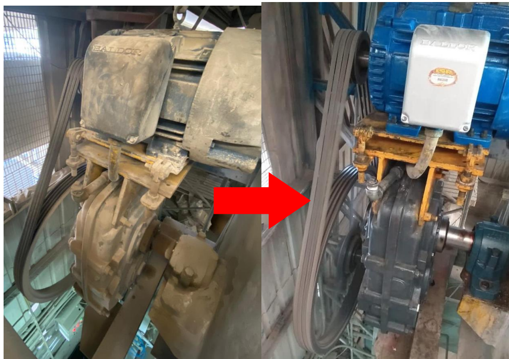
Figura 12: Antes y después del mantenimiento del motor eléctrico de la mezcladora. Fuente: Elaboración propia.
