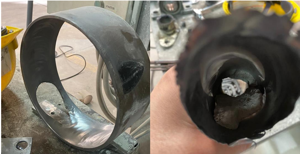
Figura 13: Estado del aro y la boquilla al realizar plan de mantenimiento por primera vez.
