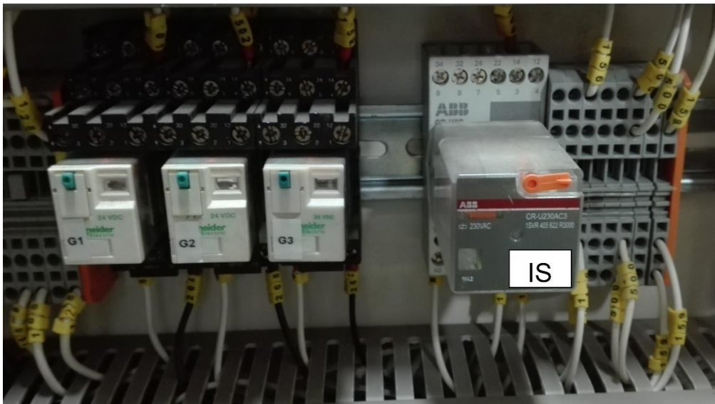
Ilustración 1-7: Relés para activar interruptor de barra de sincronismo.
