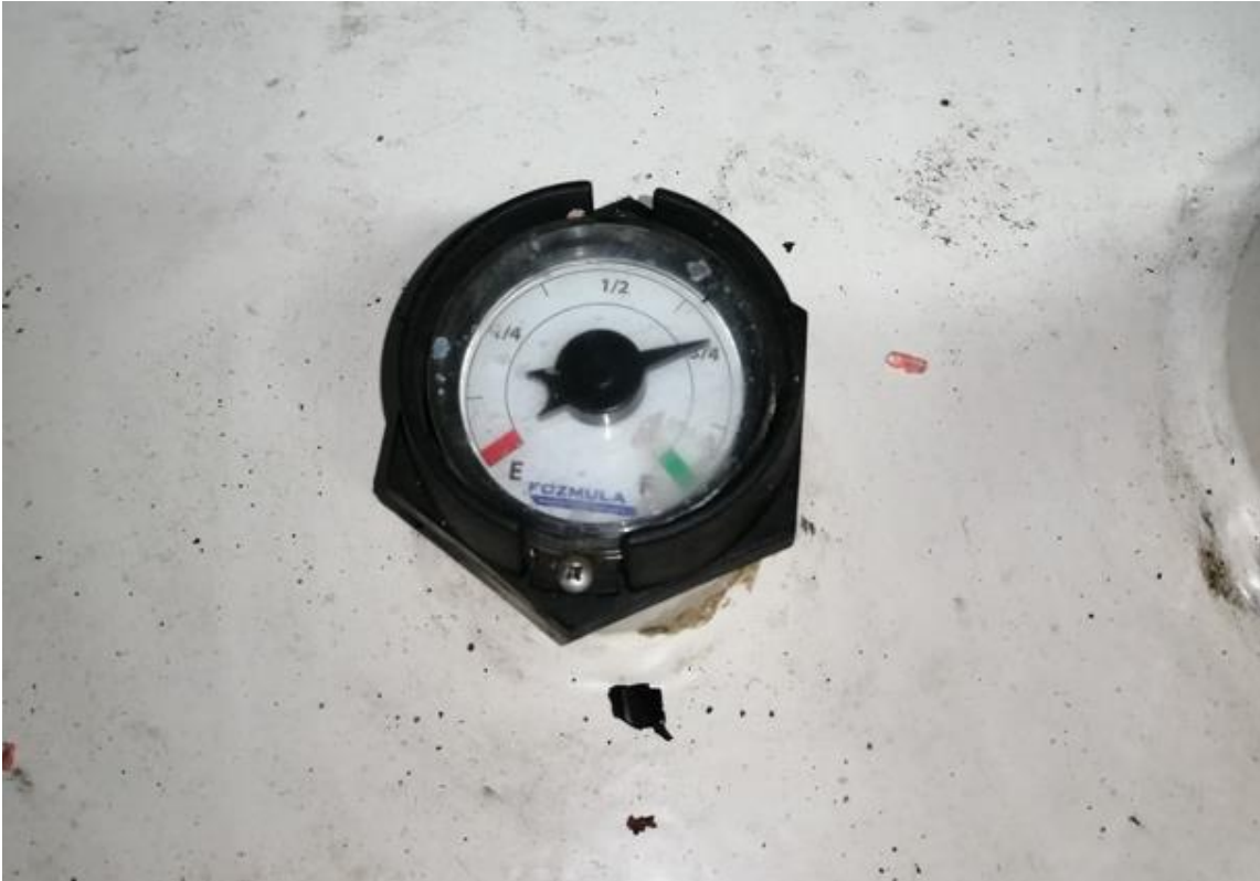
Ilustración 1-13: Indicador de nivel instalado en estanque de generador.
