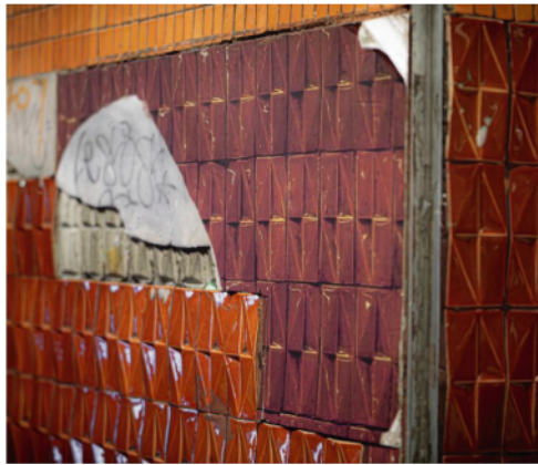
Figura 73. Deterioro L1. Fuente: The Clinic (2024).
