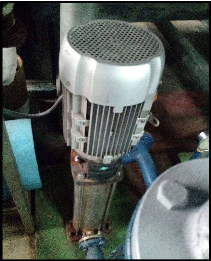
Fuente: Fotografía propia tomada a “BOMBA VERTICAL “GRUNDFOS””.
