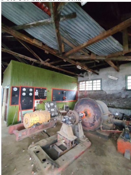
Foto 30: Sala de turbina
