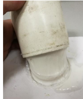
Imagen Anexo 3.3.1.1 - Matriz viscosa por falta de catalizador.
