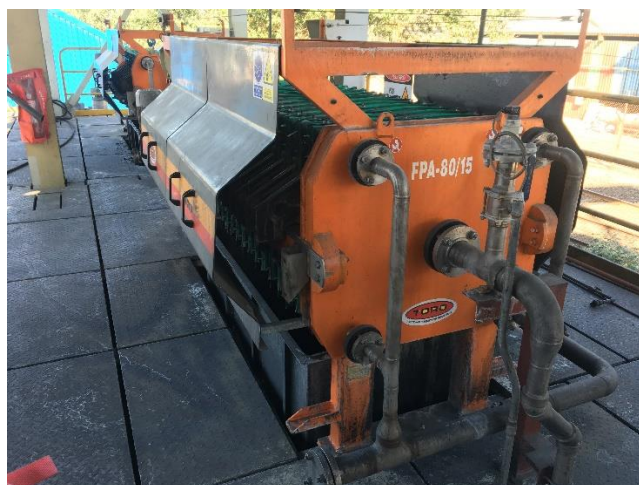
Ilustración F.2: Filtro prensa automático N°1 de hornos de limpieza de escoria
