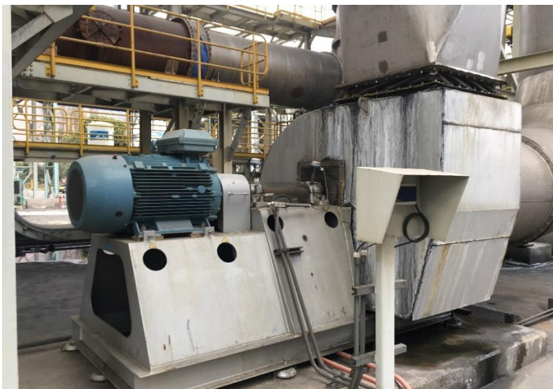
Ilustración E.2: Ventilador de tiro inducido de hornos de refinación.
