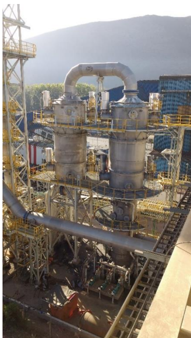
Ilustración 2.9: Precipitador electrostático húmedo N°1 y N°2 de hornos de limpieza de escoria. (Wesp 1 y 2 visto de derecha a izquierda)
