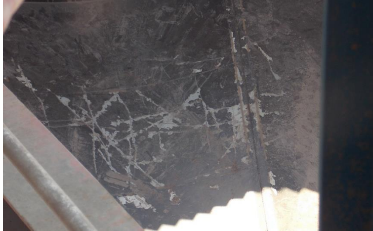
Figura 5 Daños sobre la superficie del espesador
