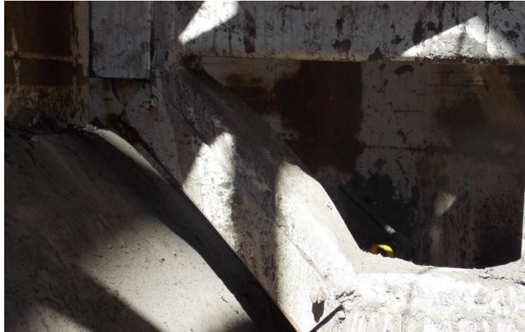
Figura 4 Daños en zona de las rastras en la zona del scraper
