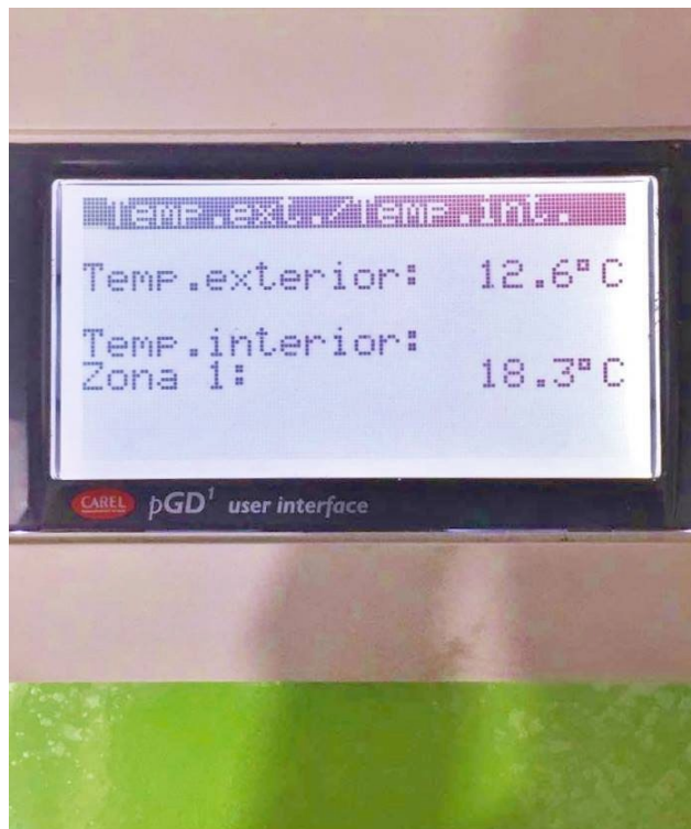
Figura 4.6 registros de temperaturas interior y exterior
