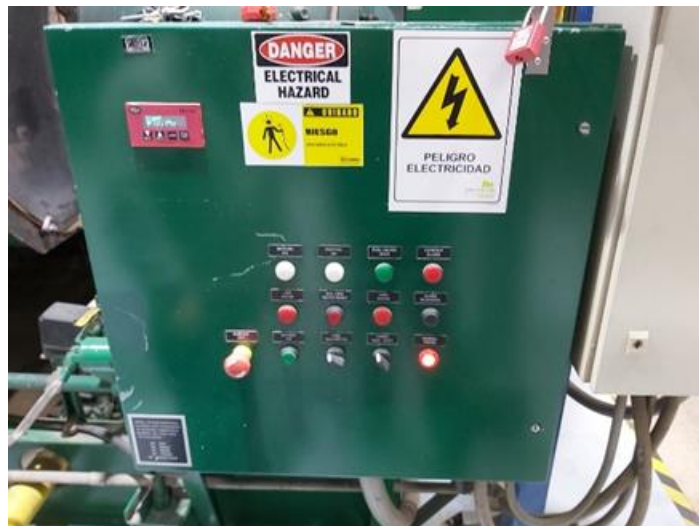
Ilustración 2- 17: Tablero manual de la caldera Johnston Boiler.
