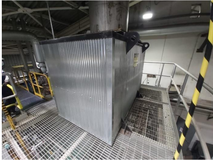
Ilustración 2- 20: Economizador instalado en la caldera Johnston Boiler.
