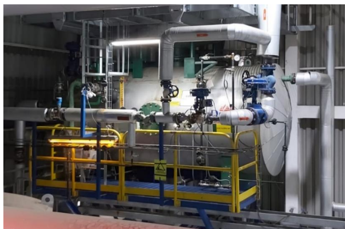
Ilustración 2- 19: Desgasificador de la sala de calderas Fábrica Nestlé Llanquihue.
