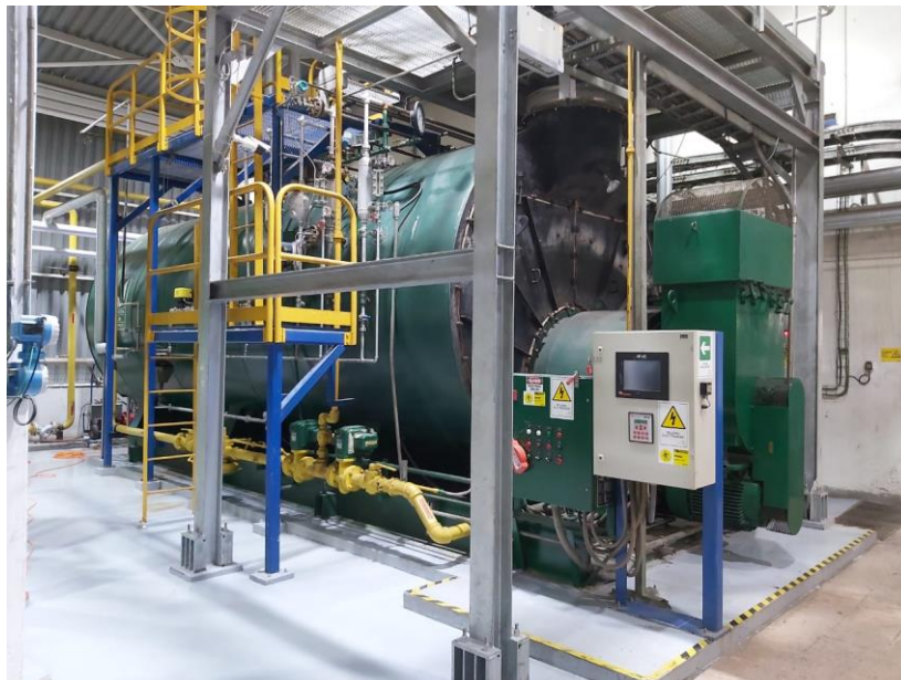
Ilustración 2- 6: Caldera Johnston Boiler PFTA1000 perteneciente a la Fábrica Nestlé Llanquihue.
