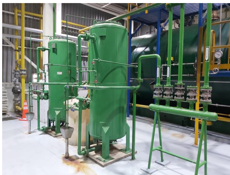
Ilustración 2- 21: Ablandadores de la sala de calderas.
