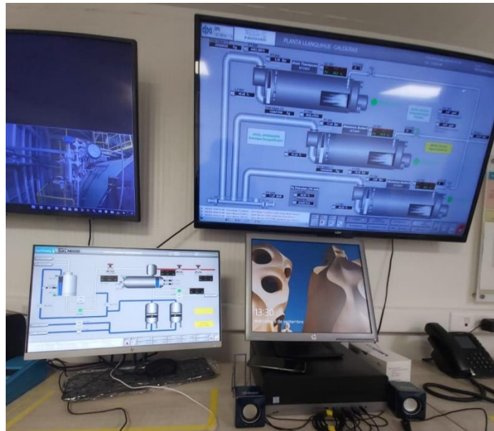
Ilustración 2- 11: Monitores de control de la sala de calderas.
