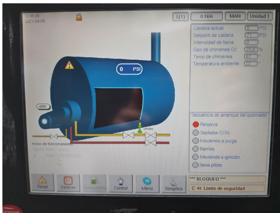
Ilustración 2- 18: Tablero automático de la caldera Johnston Boiler.
