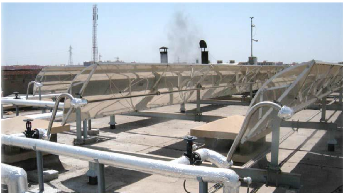
Figura 4: Instalación en Marruecos (Motta, 2010).
