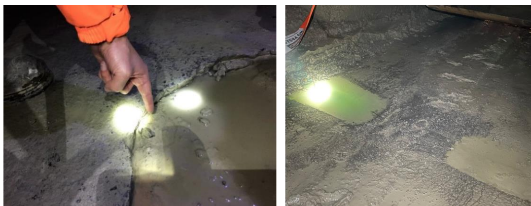
Figura 3.44. Daños por deficiente calidad de la sub-base. Ref: Muñoz R. (2010).
