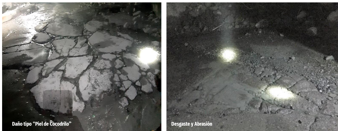
Figura 3.42. Agrietamiento tipo “Piel de cocodrilo”. Ref: Muñoz R. (2010).
