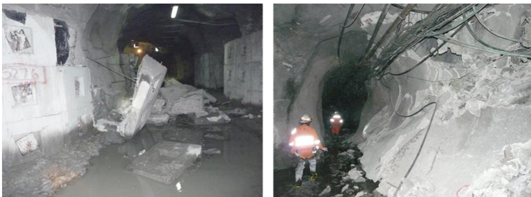
Figura 2.20. Daños típicos asociados al estallido de roca. Ref: Muñoz R. & Balboa S. (2011).
