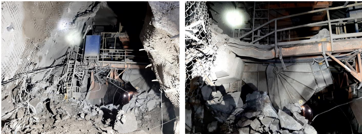
Figura 3.67. Daños por estallido de roca en Buzones. Ref: Muñoz R. (2024).
