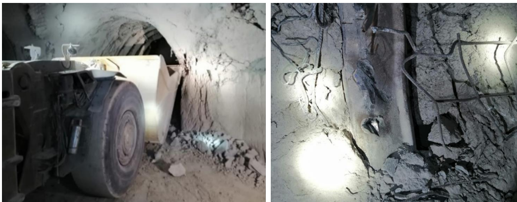
Figura 2.23. Golpes de equipos a marcos de acero. Ref: Muñoz R. (2024).
