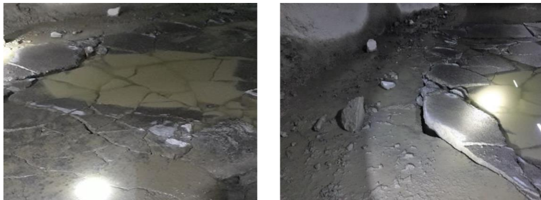
Figura 3.43. Daños por condiciones operacionales en el Nivel de acarreo. Ref: Muñoz R. (2010).
