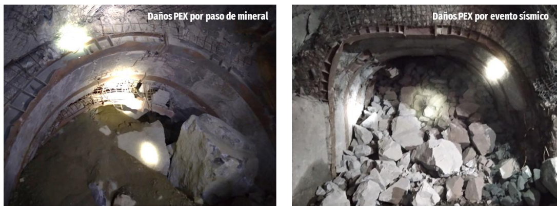
Figura 3.38. Daños por reducción secundaria y evento sísmico. Ref: Muñoz R. (2024).
