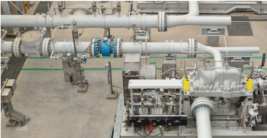
Figura 5- 5: Planta de impulsión desaladora Caitan.
