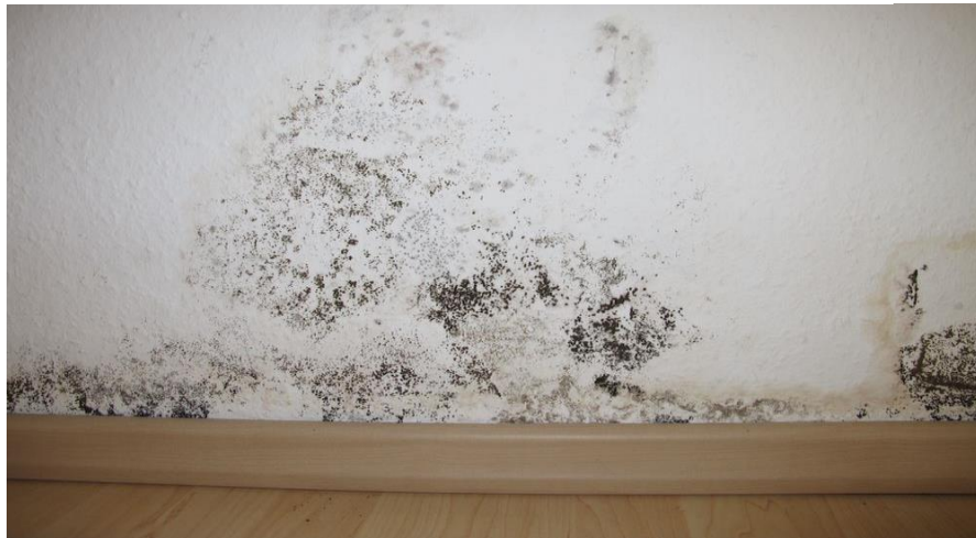
Imagen 1-9: Mohos y hongos producto de la humedad
