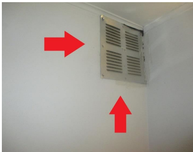
Imagen 3-1: Celosía de aluminio encargada de ventilar el baño.
