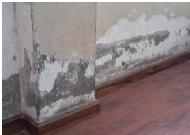
Imagen 1-7: Eflorescencias producto de la humedad en un muro
