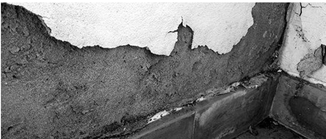
Imagen 1-8: Criptoflorescencias producto de la humedad
