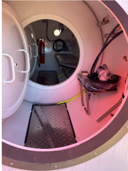
Ilustración 1- 15: antecámara. POMMEC DDC-1600.
