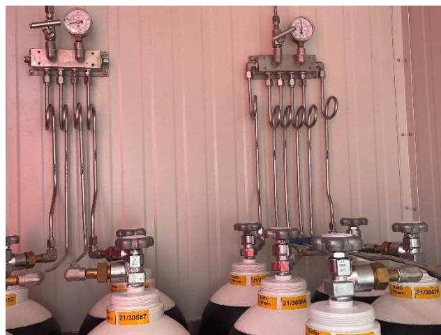
Ilustración 3- 24: Cámara Hiperbárica containerizada POMMEC DDC-1600.
