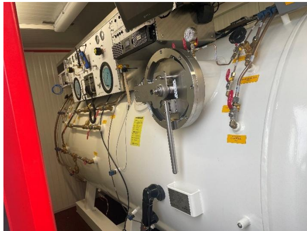
Ilustración 3- 22: Cámara Hiperbárica containerizada POMMEC DDC-1600.
