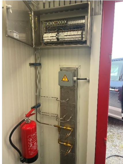
Ilustración 3- 25: Cámara Hiperbárica containerizada POMMEC DDC-1600.
