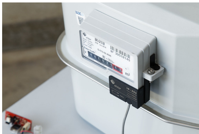
Fig. 2.13: Medidor de gas con detector magnético.
