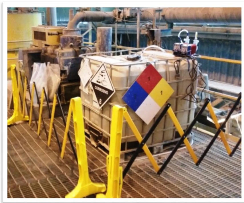
Figura 3.9. Instalación en PCLC para la adición de reactivo en avance.
