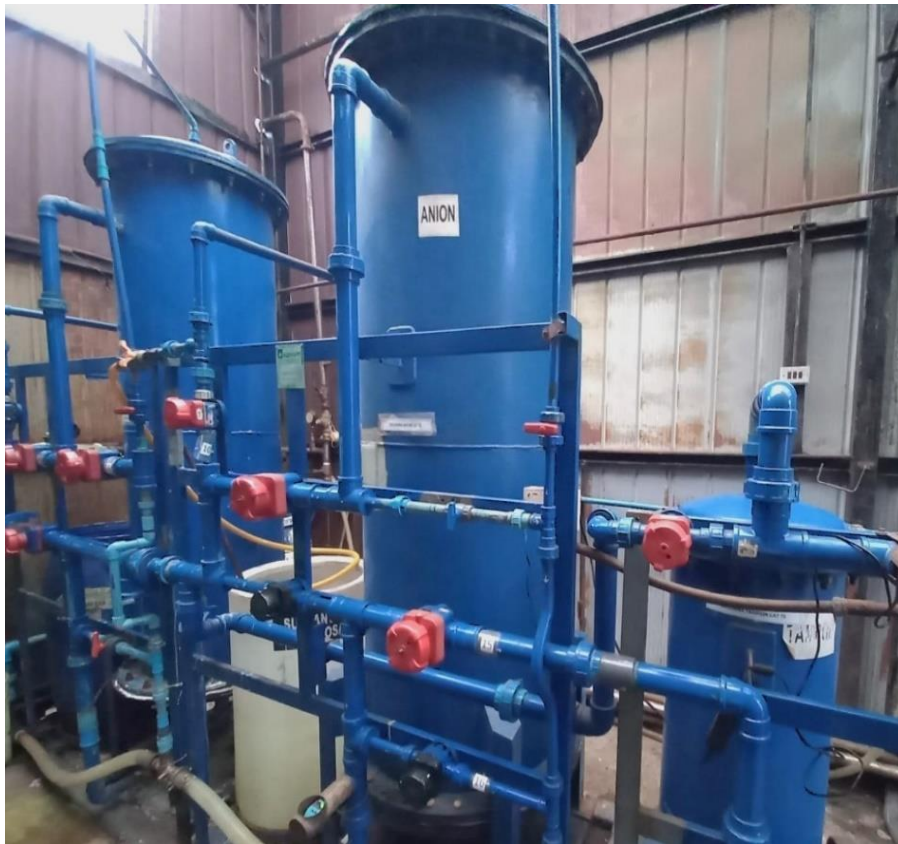
Figura 1- 2 Planta desionizadora de aguas Empresas Demaria S.A.
