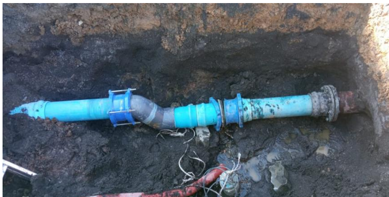
Figura: Rotura de unión de cañerías PVC-ACERO
