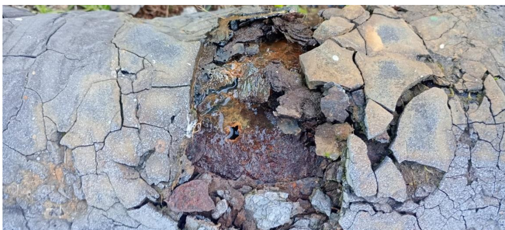
Figura: Corrosión pitting
