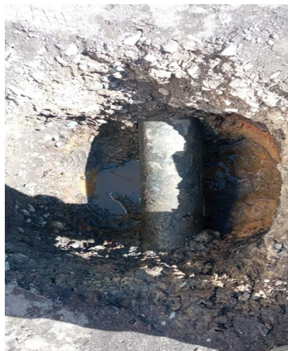
Figura: Cañería afectada por corrosión uniforme
