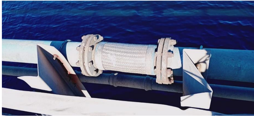
Figura: Unión flexible brida de acero en Muelle 2
