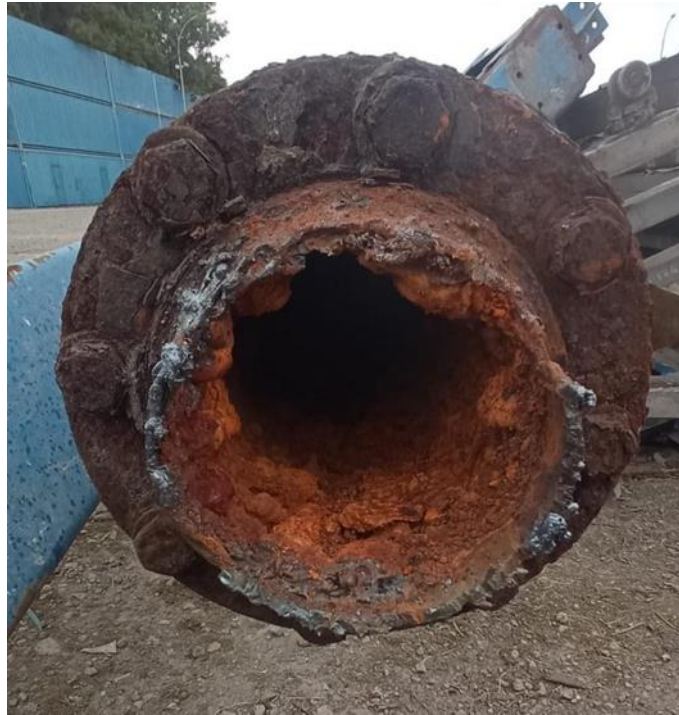
Figura: Cañería con deterioro por corrosión
