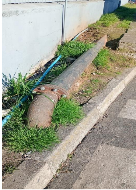
Figura: Tubería enterrada.
