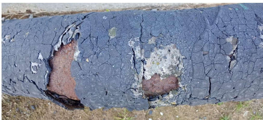
Figura: Deterioro actual de sistema de protección por revestimiento
