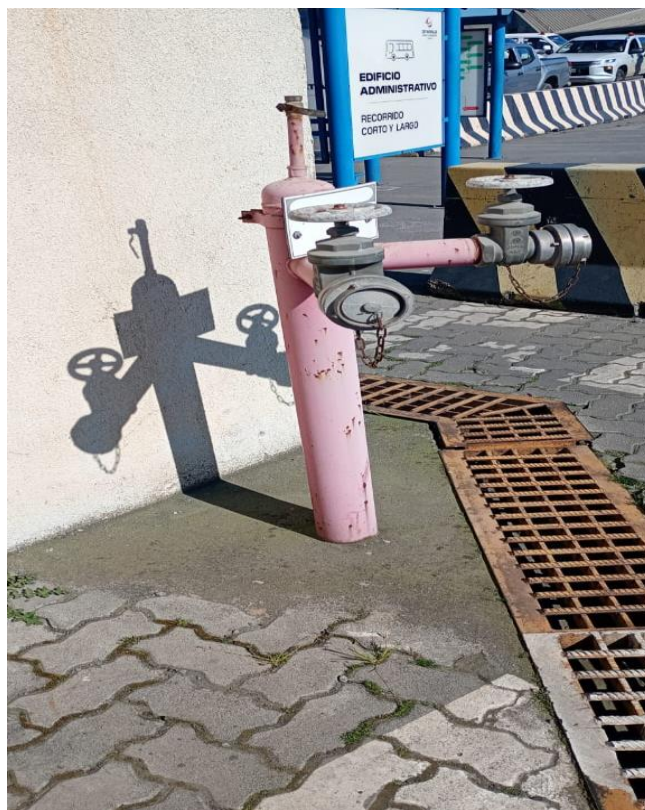
Figura: Grifo a un costado de sala de bombas Fuente: Propia
