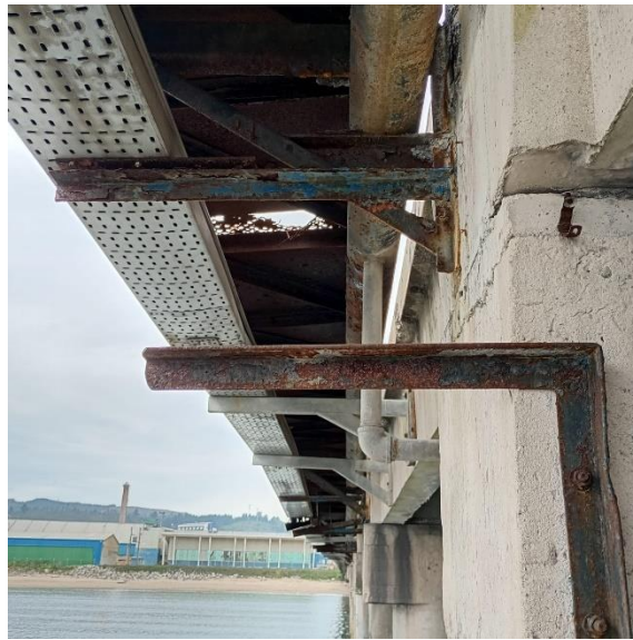
Figura: Soportes de cañerías corroídos por fricción
