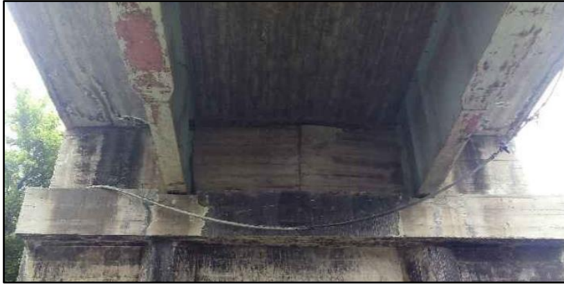
Fig 10. Viga de acero corroída.
