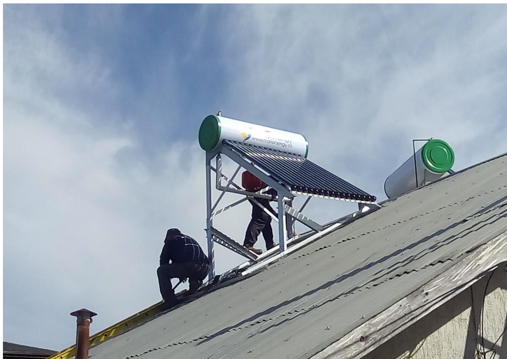
Figura 1. 2 Energía Solar Térmica para ACS
