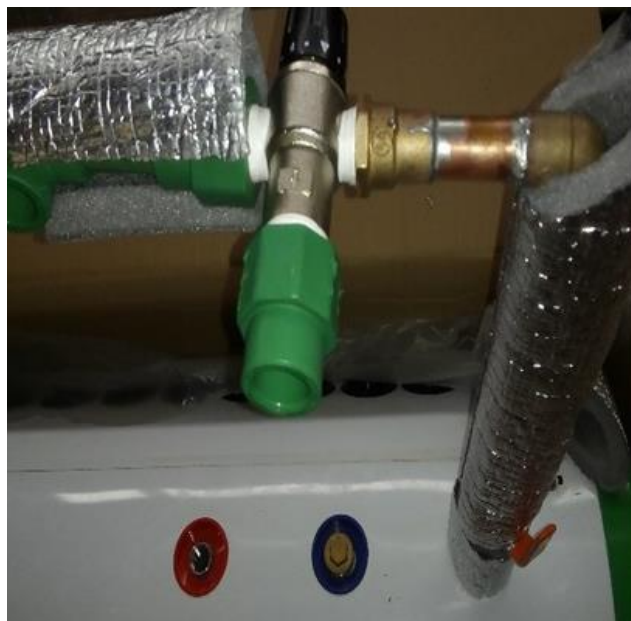
Figura 2. 17 Válvula mezcladora termostática instaladas cerca del DA
