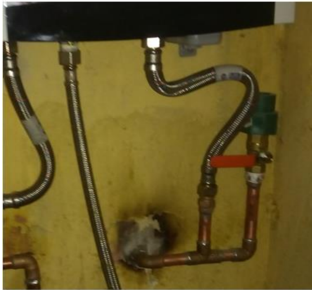
Figura 2. 15 Válvula de seguridad tipo bola ½” suministro de agua fría.
