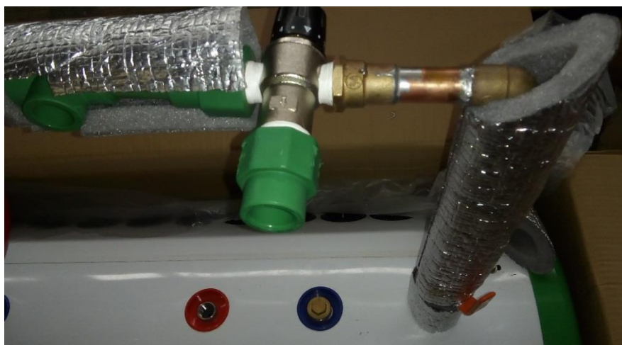
Figura 3. 7 Aislación válvulas mezcladoras termo estática
