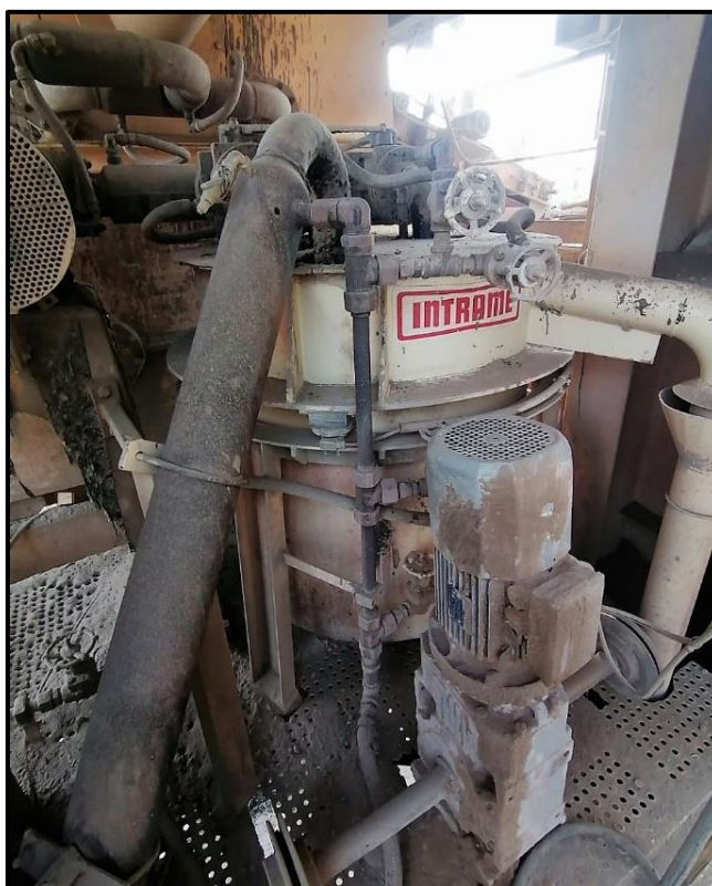
Figura 2.23. Contenedor de ligante asfáltico montado en celdas de carga (Planta Bitumix Maipú). Fuente: Elaboración propia.
