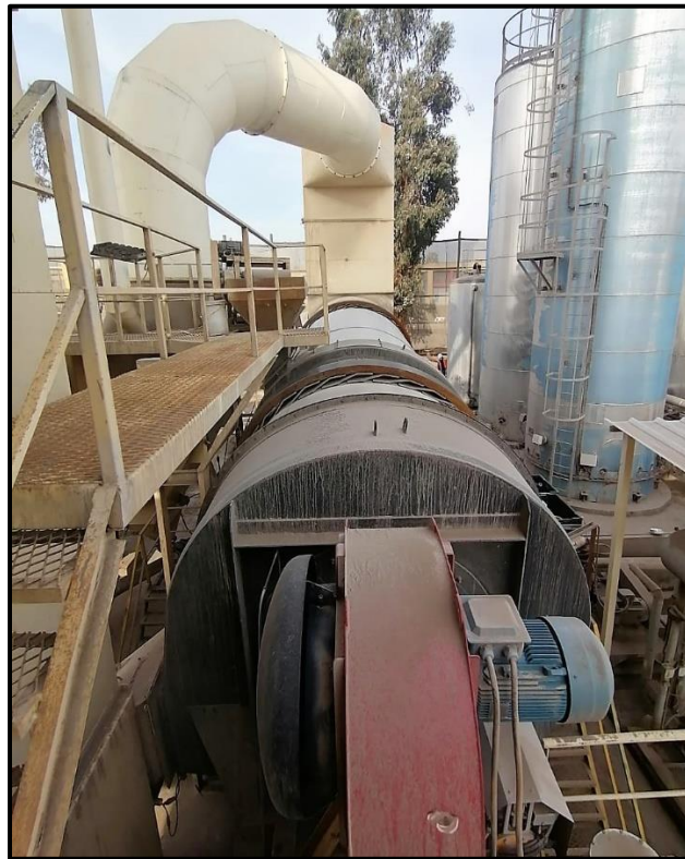
Figura 2.9. Secador (Planta Bitumix Maipú). Fuente: Elaboración propia.
