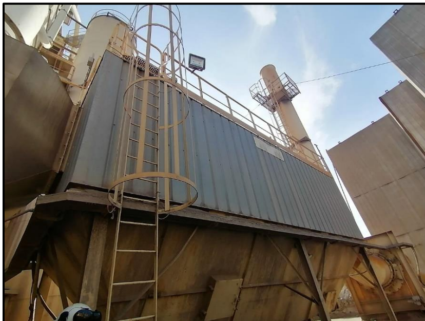
Figura 2.15. Filtro de mangas (Planta Bitumix Maipú). Fuente: Elaboración propia.
