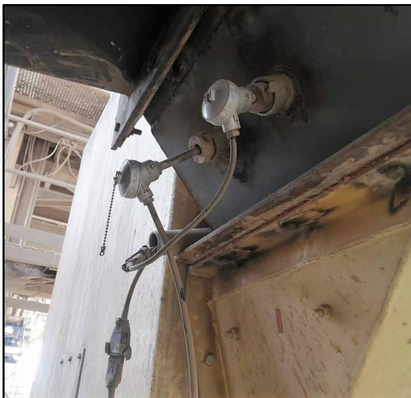
Figura 2.13. Equipo termométrico en descarga del secador (Planta Bitumix Maipú). Fuente: Elaboración propia.
