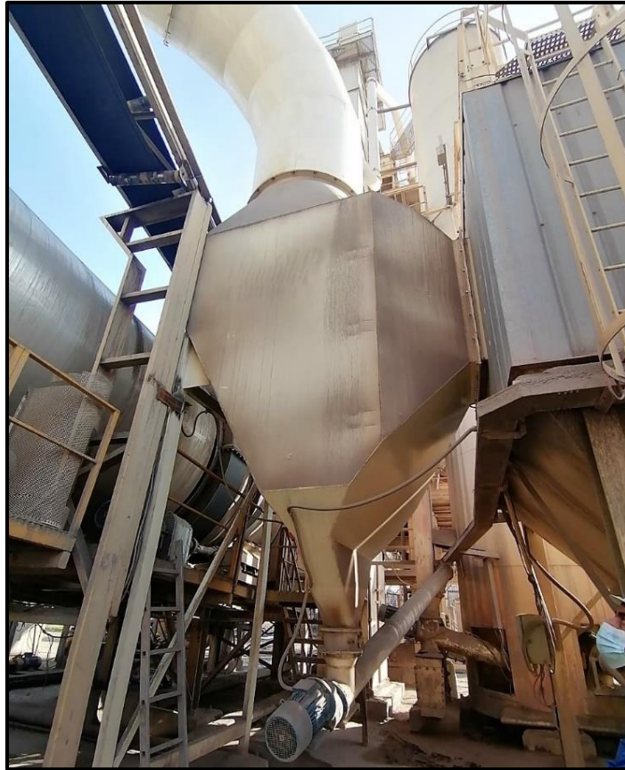
Figura 2.14. Colector primario (Planta Bitumix Maipú). Fuente: Elaboración propia.
