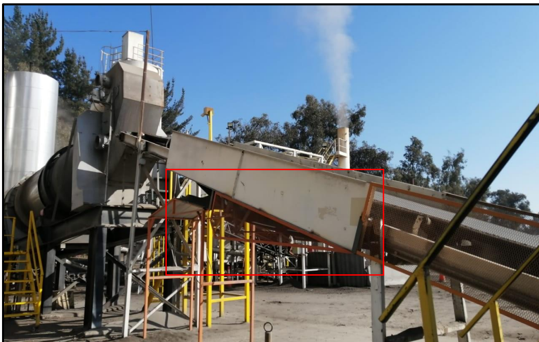
Figura 2.26. Sistema de pesaje en cinta transportadora (Planta Bitumix Rancagua). Fuente: Elaboración propia.
