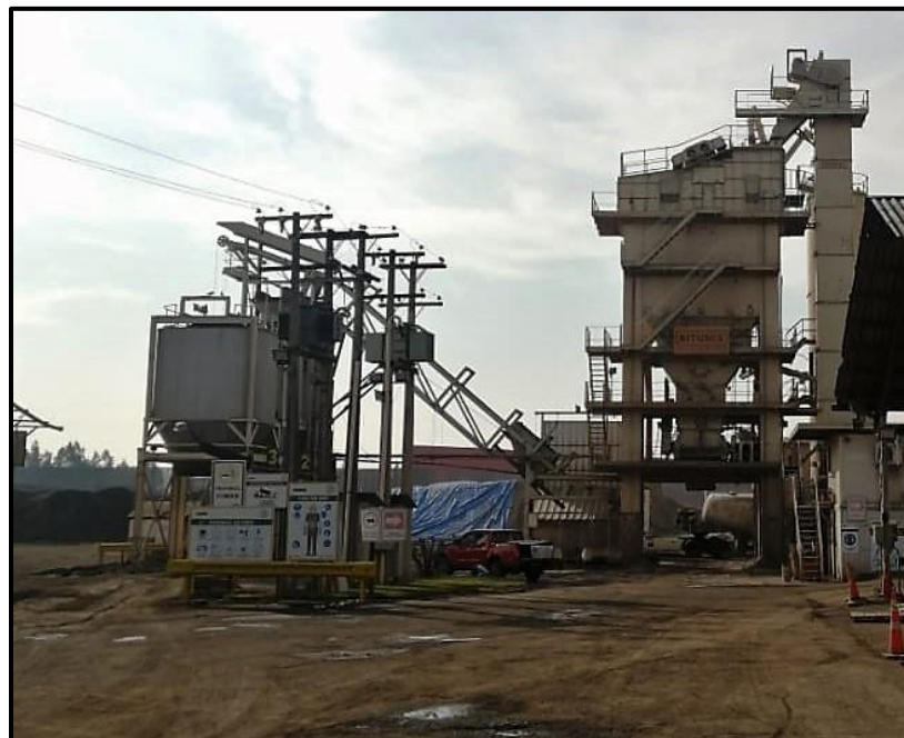
Figura 2.21. Planta discontinua Bitumix Maipú. Fuente: Elaboración propia.
